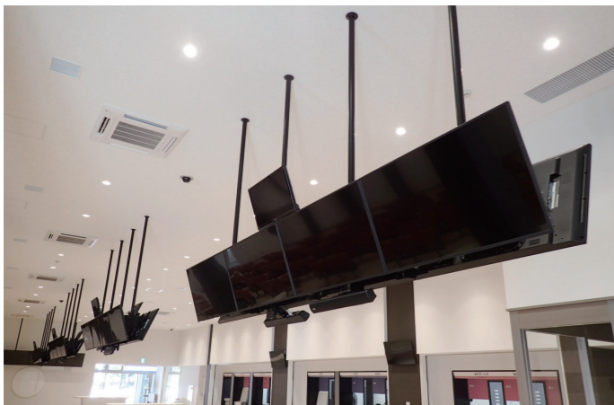
某商業施設 横マルチ天吊り
