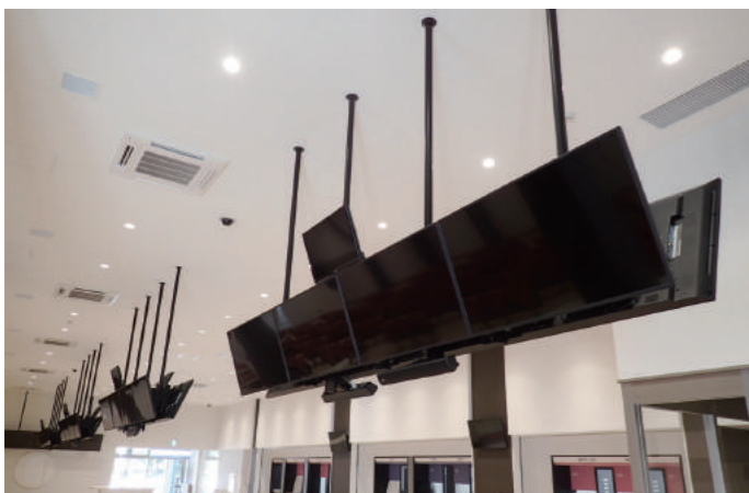
某商業施設 横マルチ天吊り
