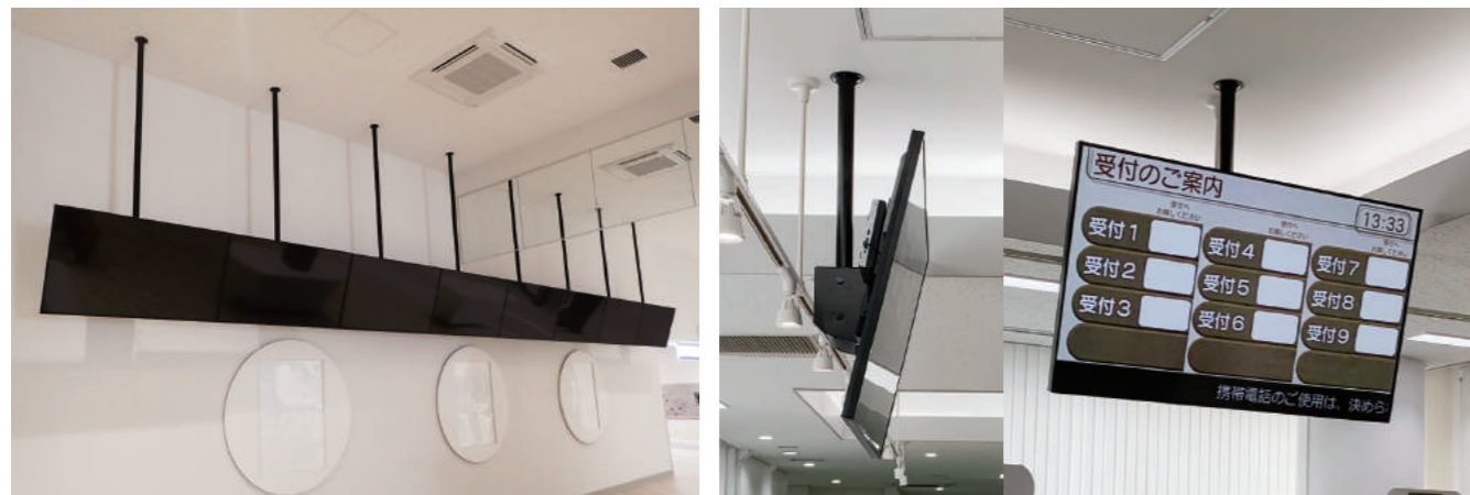
某商業施設 8面横マルチ天吊り
